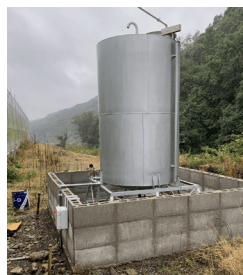
石油タンク コントローラ
